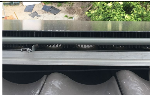
Figuur 25: Triple Solar PVT warmtepomppaneel geïnstalleerd op een schuin dak (van bovenaf gefotografeerd, waardoor de convectieribben goed zichtbaar zijn) (foto: Sabine Jansen)
